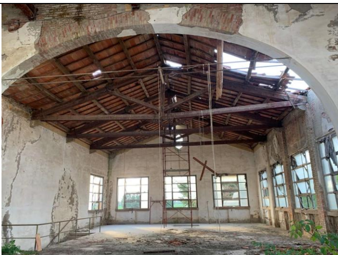
Sala con l'arrivo della scala e crollo parziale copertura al piano primo_nord-ovest
