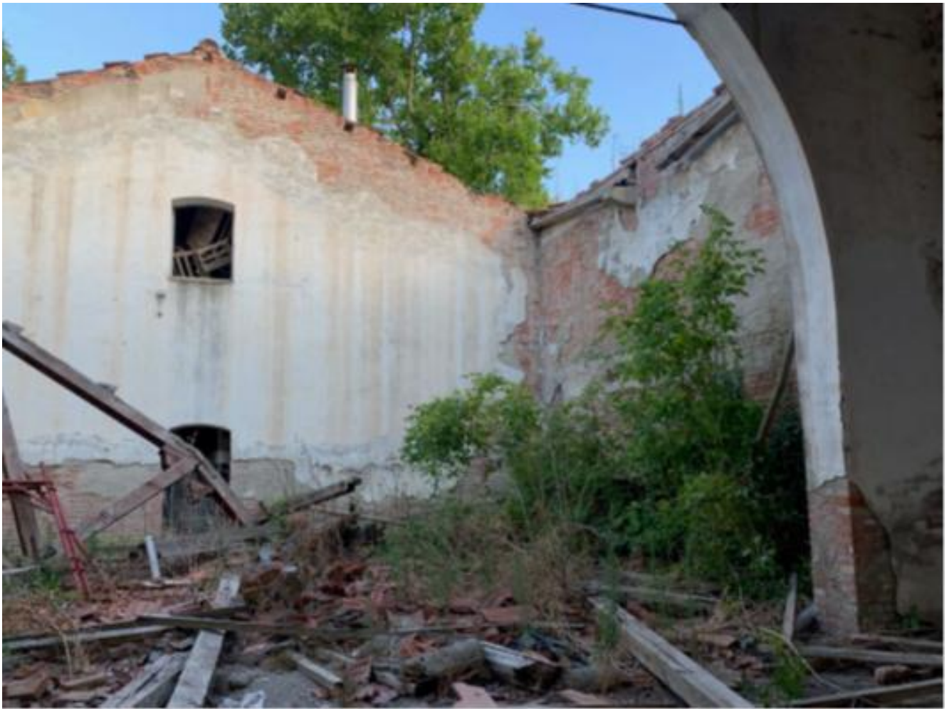
Crollo totale della copertura e vista del fronte con timpano piano primo_ala nord-est
