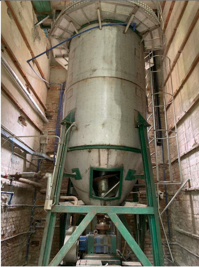
Locale caldaia al piano terra_nord-est
