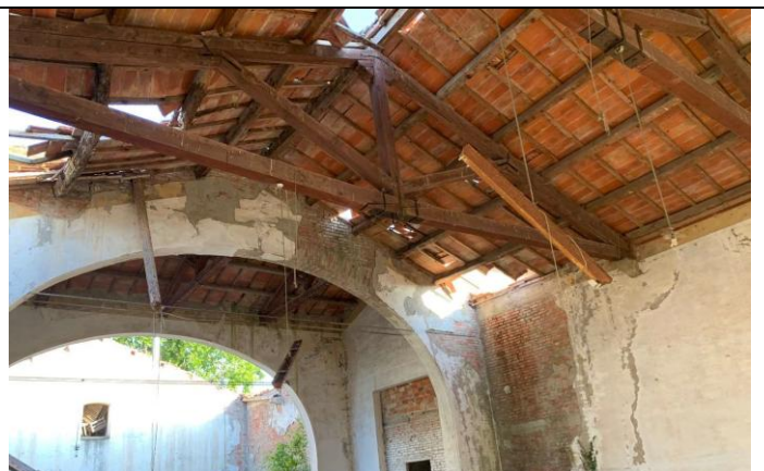
Scorcio del crollo della copertura a capanna delle sale al piano primo_nord-est
