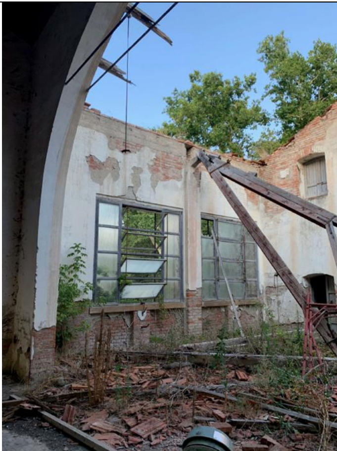
Scorcio del crollo totale della copertura delle sale al piano primo_nord-est
