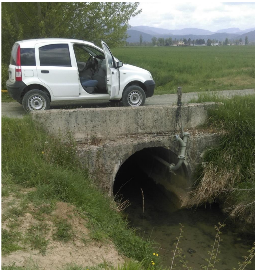
Figura 6: Tombolatura del diametro di 1200 mm poco prima del ponte sotto la SS73 in località Corpo del Sole della Gavina senza nome (3)
