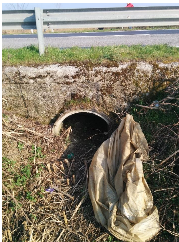
Figura 9: Tombino sotto la SS73 a servizio di drenaggio di alcuni campi agricoli che non hanno scolo diretto nei fossi (2) e (3)
